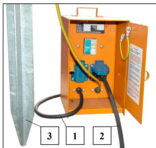
Obr. 17 malý staveništní rozvaděč
